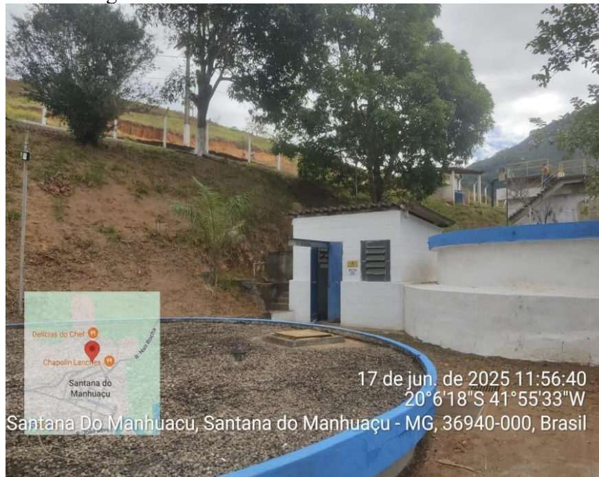
Figura 40 – Reservatório R2 enterrado de 135 m 3 .
