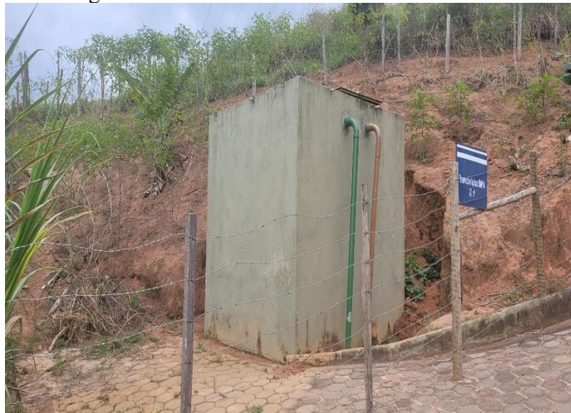
Figura 41 – Reservatório Novo Horizonte 20 m 3 .
