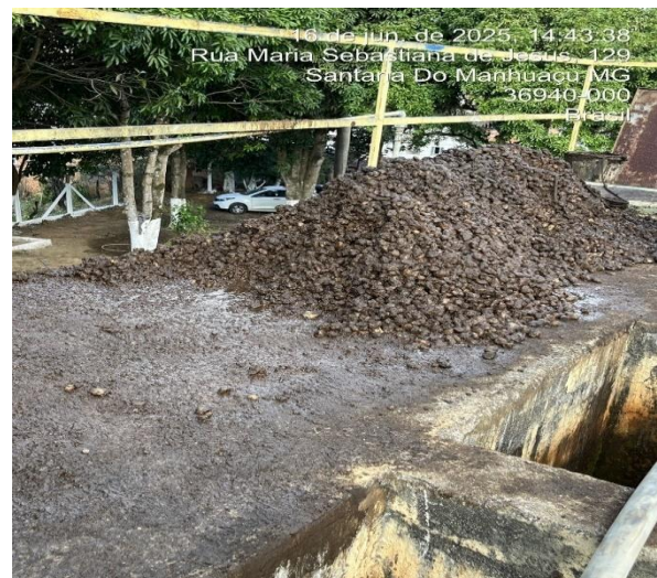
Figura 25. Troca de material Filtrante
