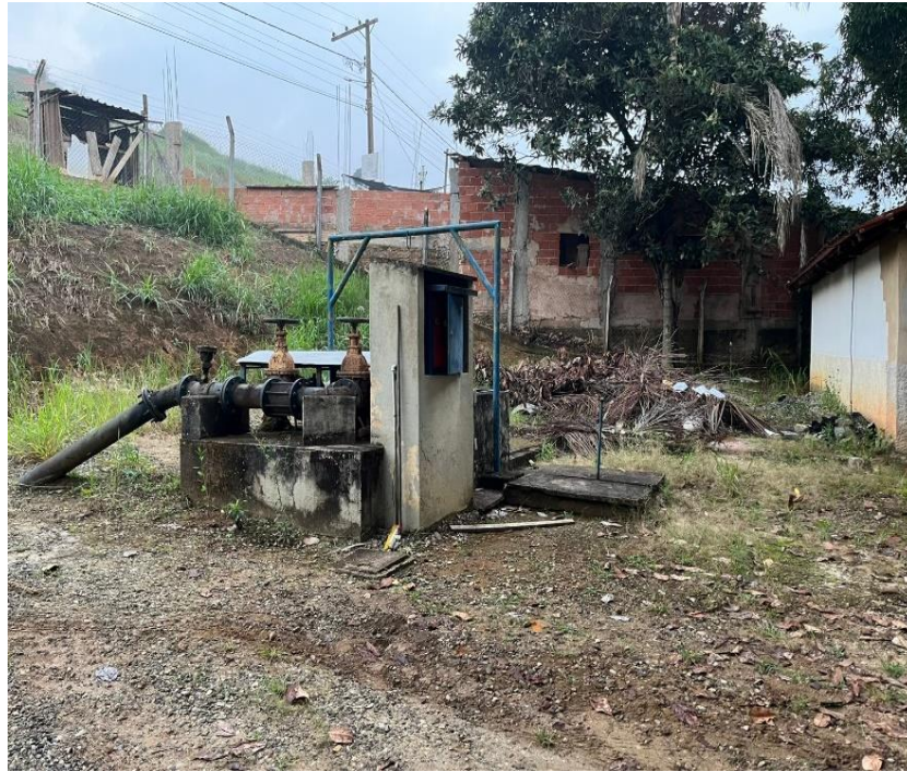
Figura 2 - Área da ETA sem a devida limpeza no início da operação do SAAE
