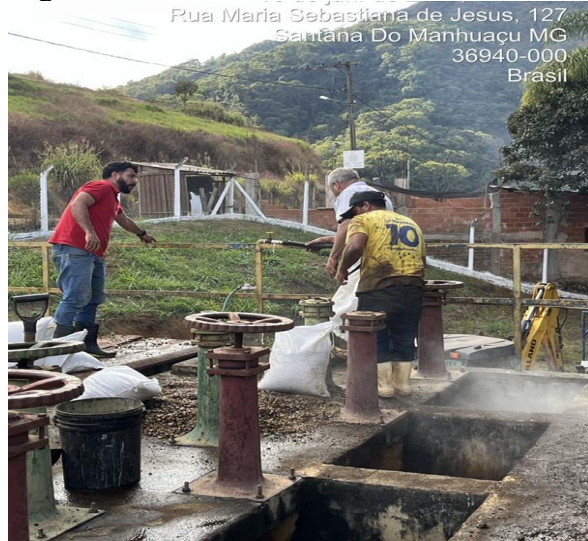
Figura 27. Troca de material filtrante
