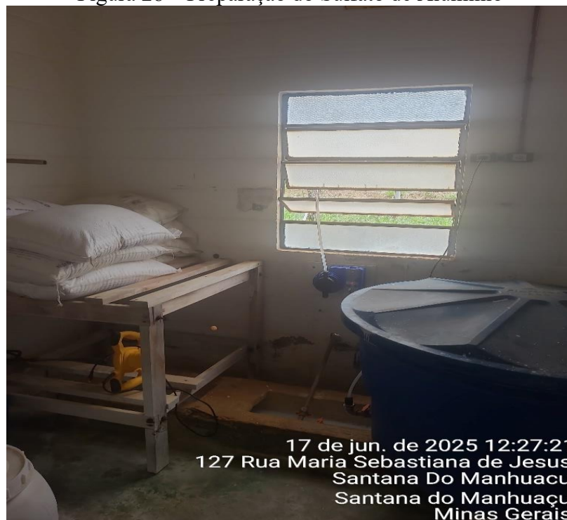
Figura 28 – Preparação do Sulfato de Alumínio
