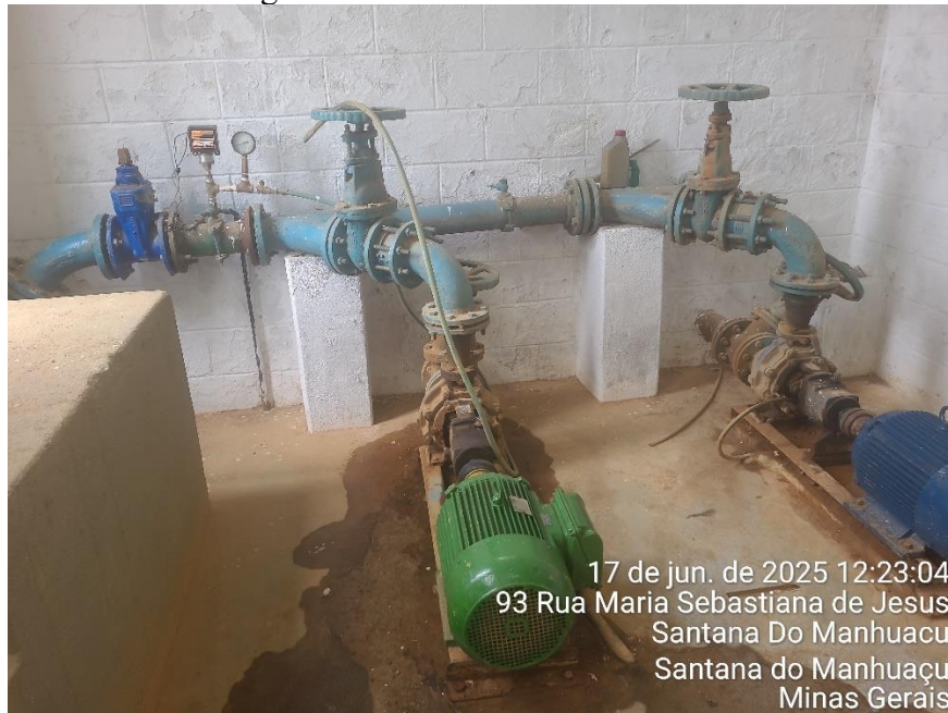
Figura 33 – Casa de Bombas - ETA
