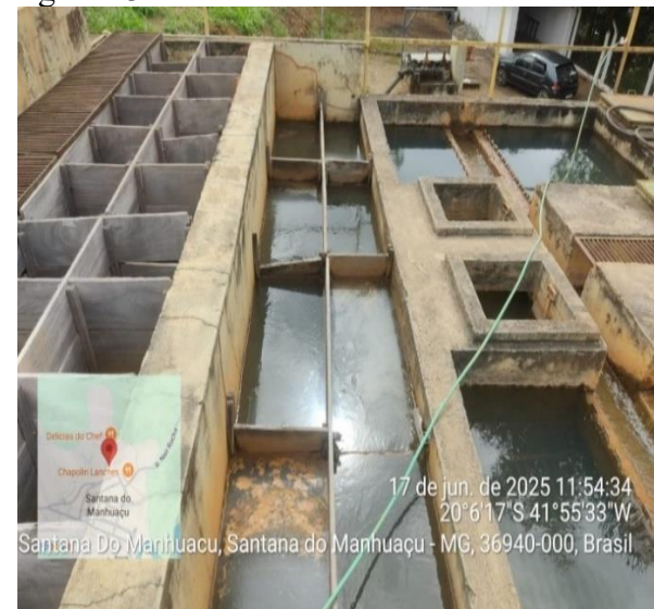
Figura 23. Decantadore na ETA vistoriada.
