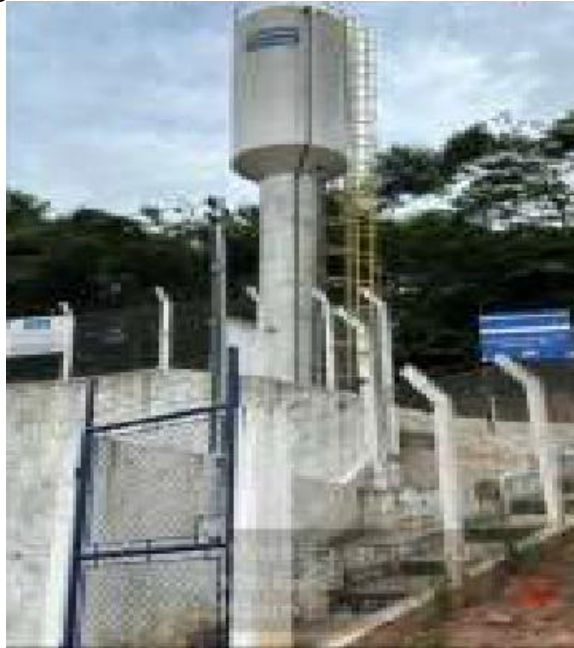
Figura 43 – Reservatório Condomínio Novo 50 m 3 .
