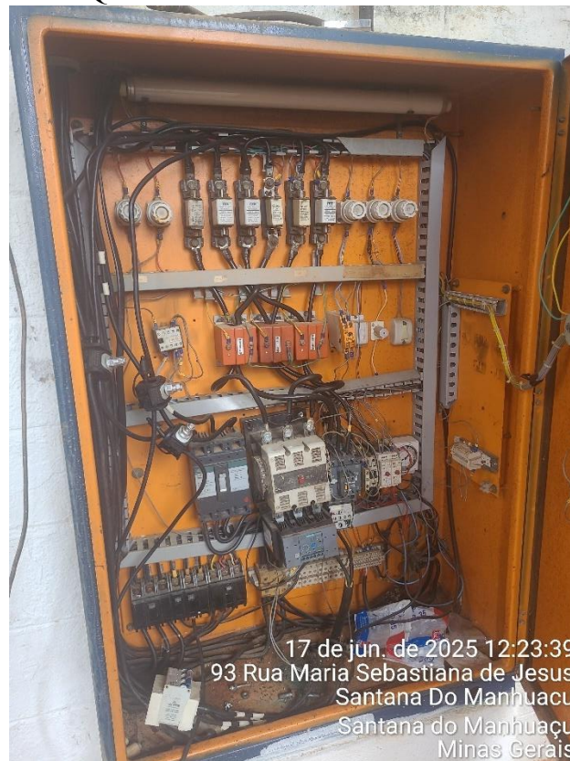
Figura 34 – Quadro de comando da Casa de Bombas - ETA
