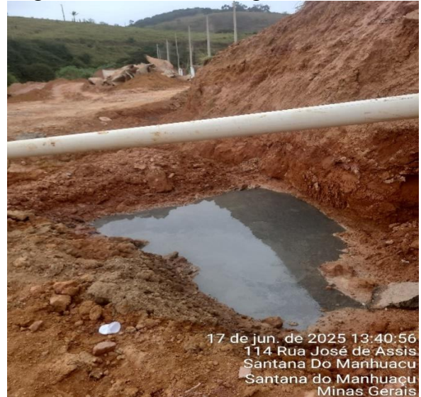
Figura 46. Descarte de esgoto no SES local
