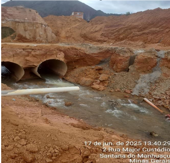
Figura 45. Descarte de esgoto no SES local
