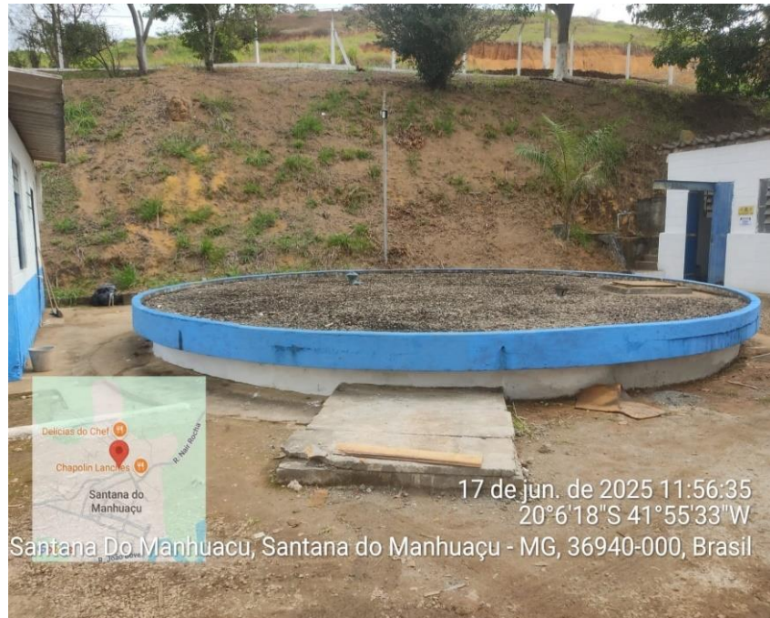
Figura 39 – Reservatório R1 enterrado de 135 m 3 .
