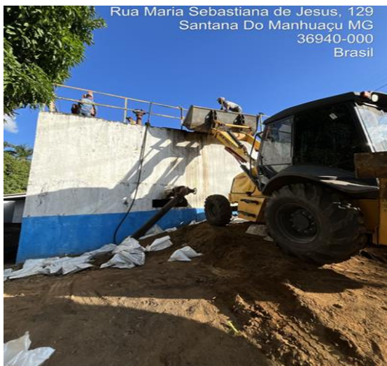
Figura 26. Troca de material filtrante
