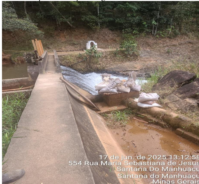
Figura 18 - Adutora rompida na adução de água bruta no SAA de Santana do Manhuaçu.
