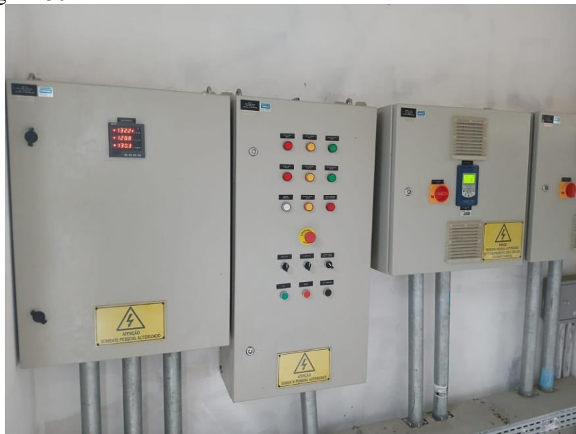
Figura 36 – Painel de controle da Casa de Bombas – Condomínio Novo
