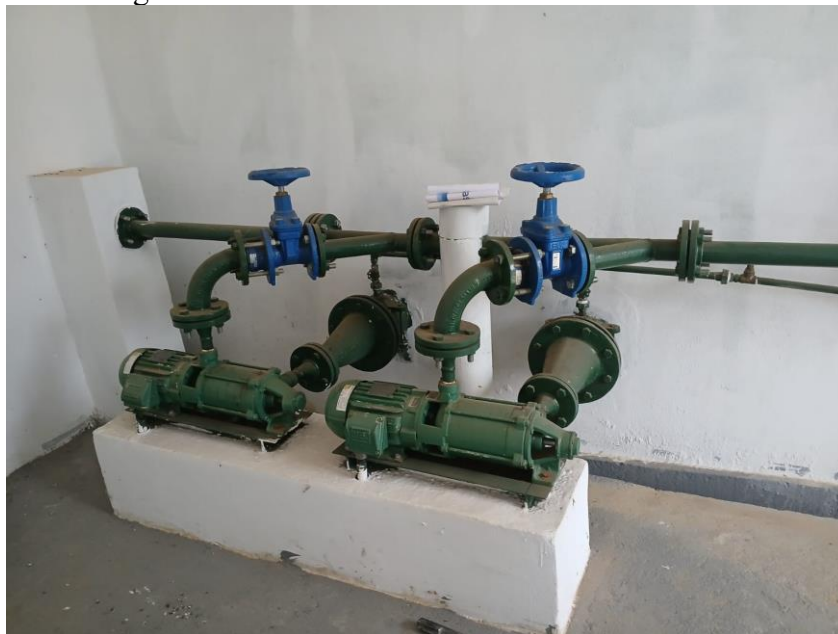
Figura 35 – Casa de Bombas – Condomínio Novo
